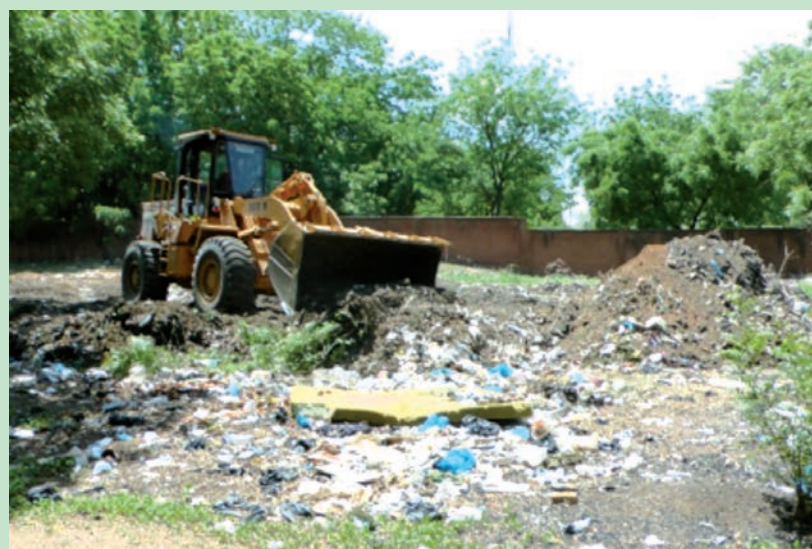
PHOTO 1. Evacuation de tas sauvage en plein centre de la ville de PO.
