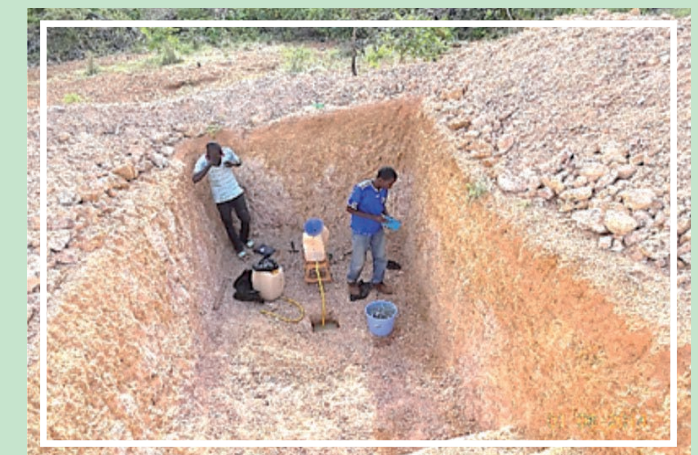
PHOTO 2 : Réalisation test de perméabilité lors de l'étude pédologique pour la réalisation de la décharge à PO
