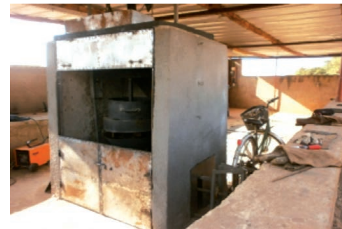
Figure 7 : la cheminée et ses accessoires
